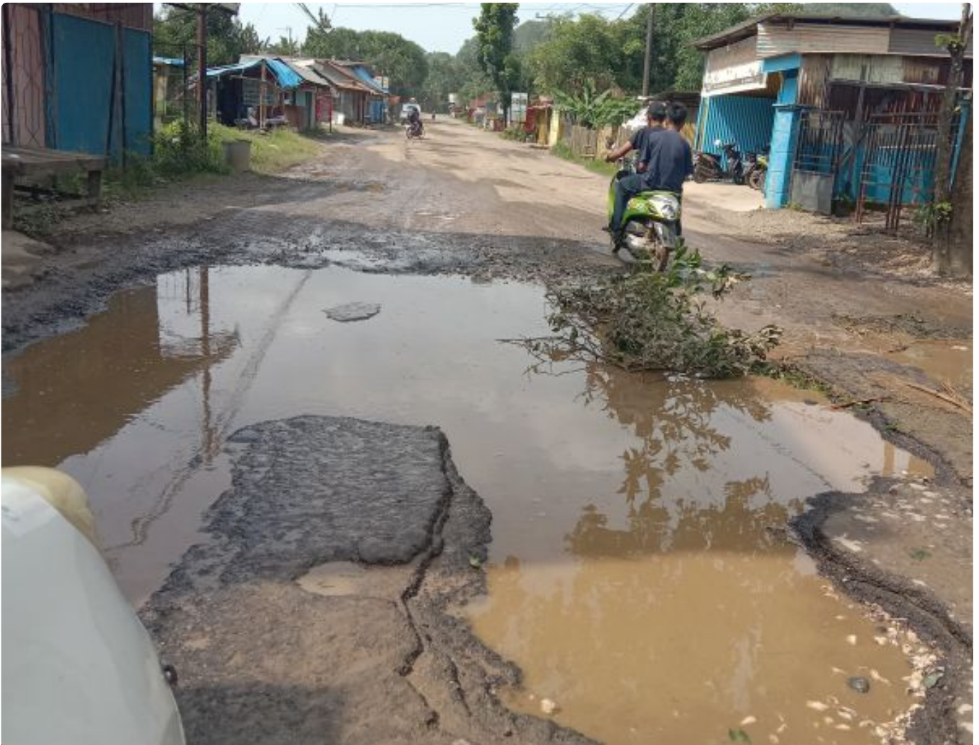
Jalan Minasate'ne rusak parah
